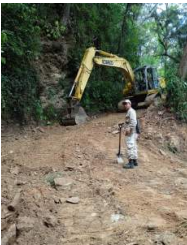
Remoción de sedimentos producto de movimiento de masa originado en el sector Lomas El Muerto del Parque Nacional Waraira Repano, Distrito Capital, en fecha 20/09/2022. Fuente: INPARQUES
